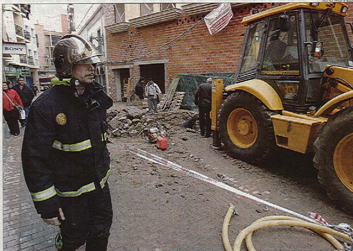
Un bombero pasa junto al lugar donde se produjo la rotura de la tubería.
